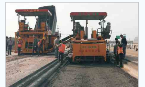
水泥浆循环搅拌装置
