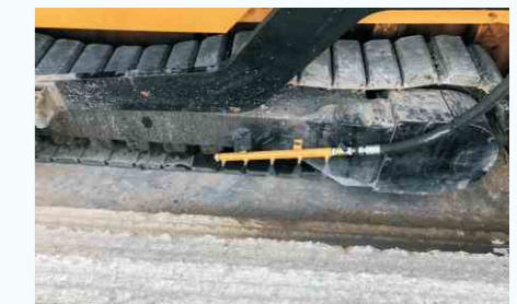
水泥浆喷洒装置
